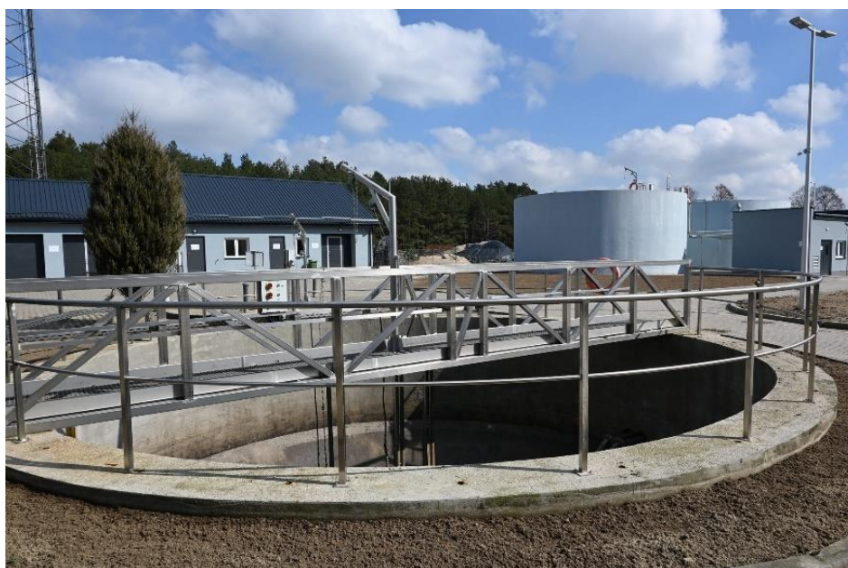
Fot. 9 Oczyszczalnia ścieków w Skrwilnie.
